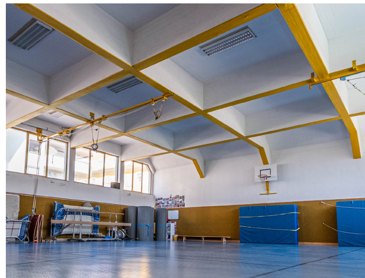
Turnhalle mit undichtem Dach
